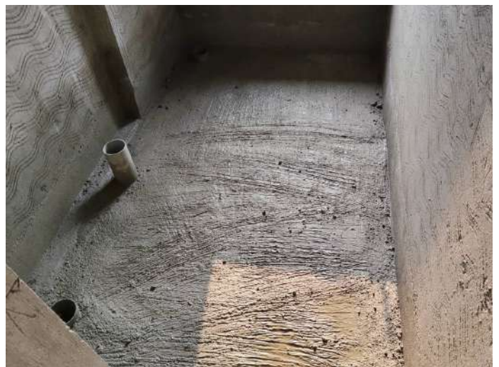
6F - Sunken Filling
