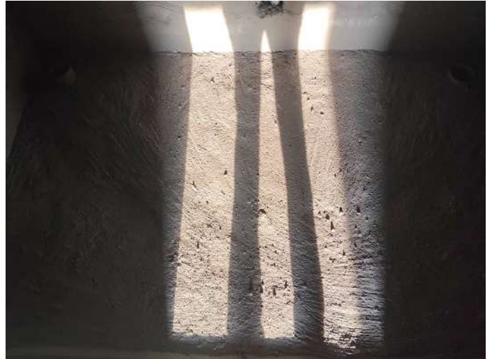
6F - Sunken Filling
