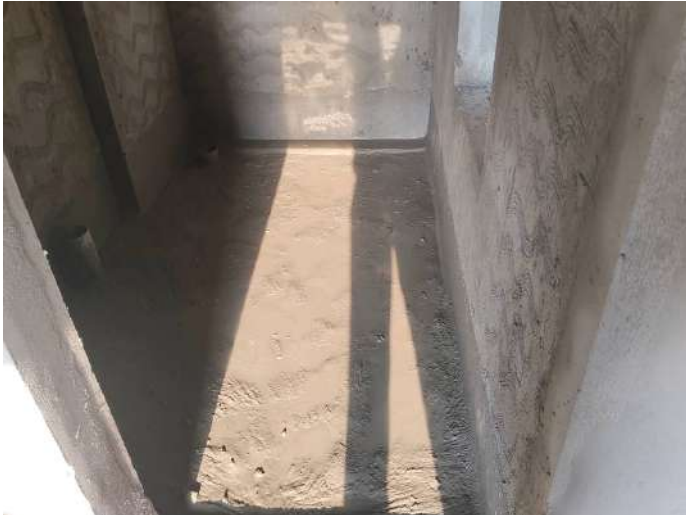
6F - Sunken Filling
