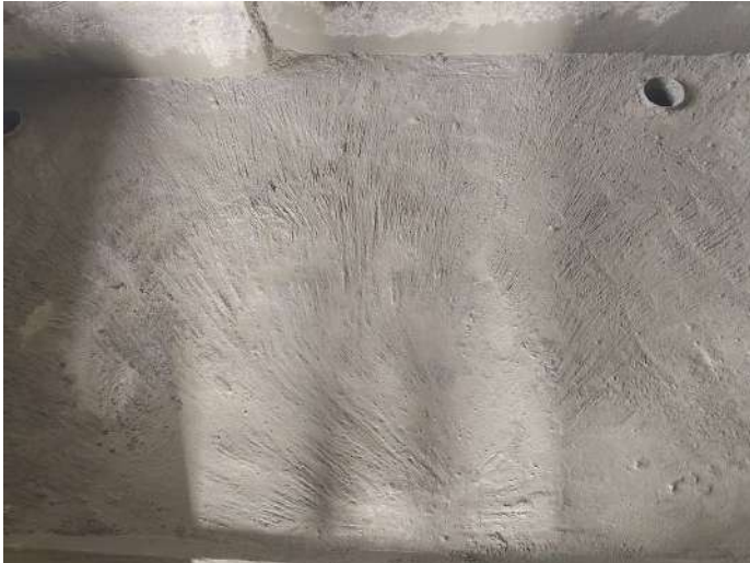
6F - Sunken Filling
