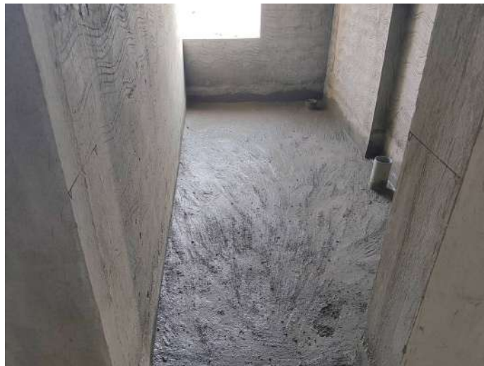
6F - Sunken Filling
