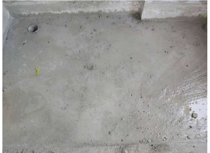
6F - Sunken Filling
