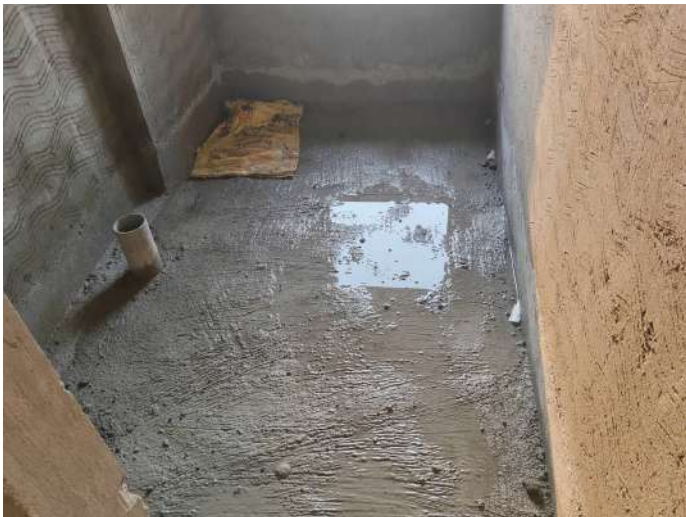
5F - Sunken Filling
