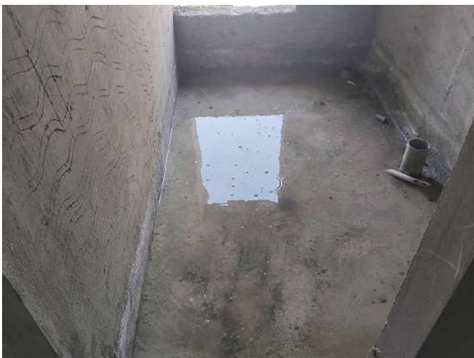
4F - Sunken Filling
